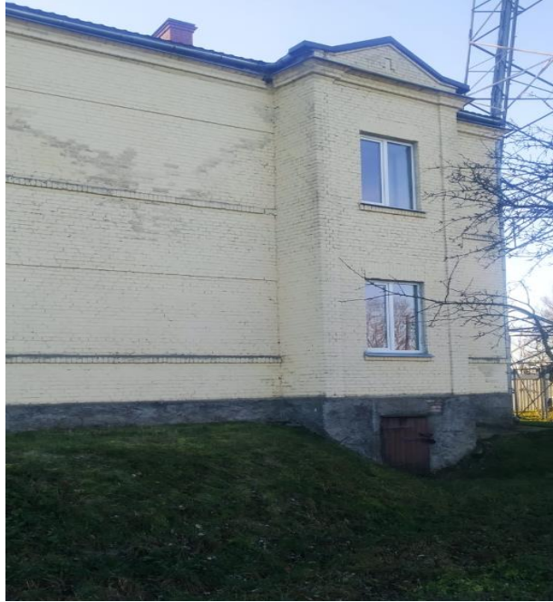
Att.Nr.3. Ēkas fasāde "C" (skat. pielikumā, sakaru nama Transporta ielā 4, Jēkabpilī, 1.stāva logu bloku shēmu)
