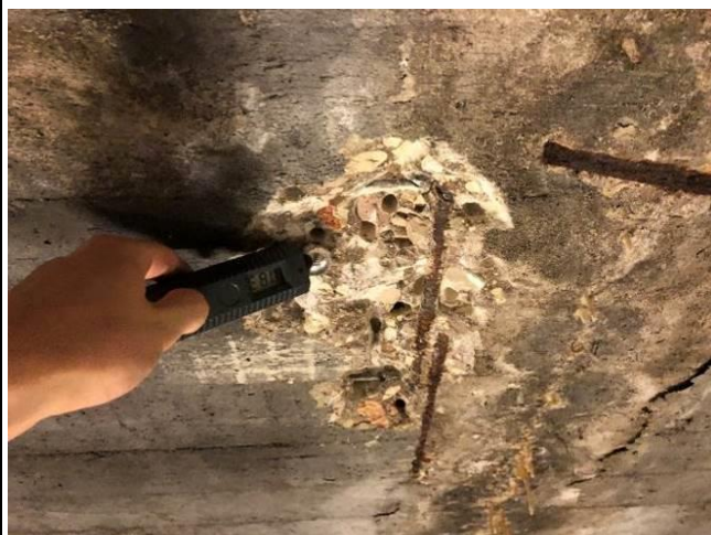
Foto Nr. 11 Mitrums betona konstrukcijā 3.5-4.0%.
