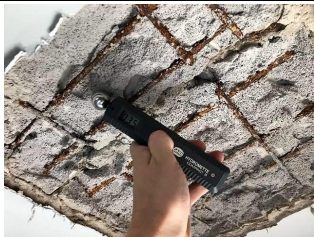
Foto Nr. 82 Mitrums gāzbetona konstrukcijā 0.4%CM.(rād. Vid.35).
