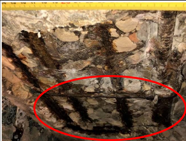
Foto Nr. 22 Nesošā stiegrojuma pilnīgs profilējuma zudums.
