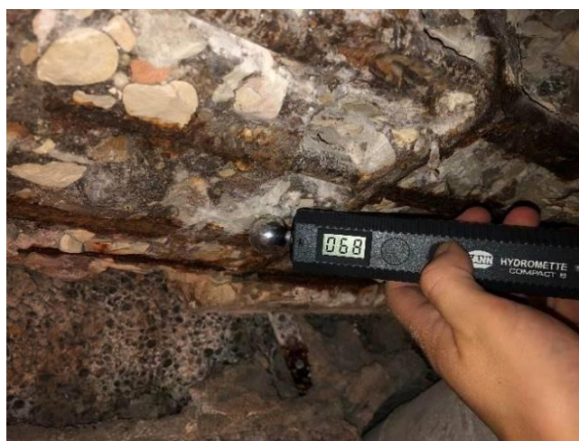
Foto Nr. 21 Mitrums betona konstrukcijā 3.5-4.0%CM.
