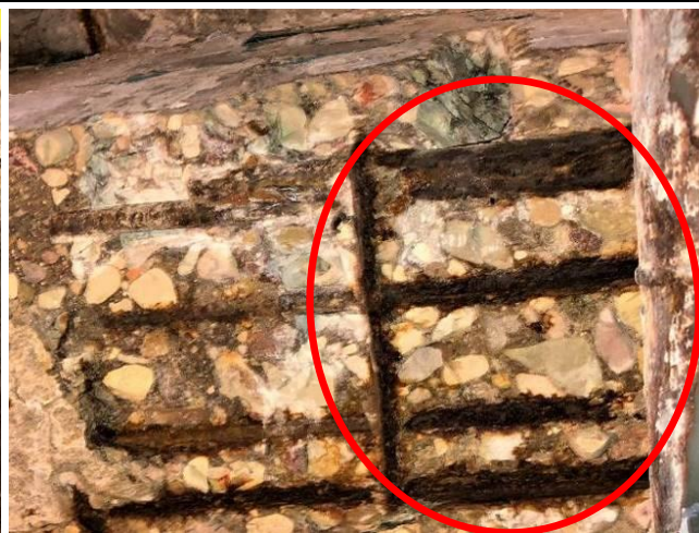
Foto Nr. 23 Nesošā stiegrojuma pilnīgs profilējuma zudums.
