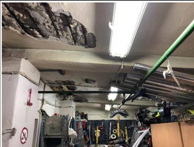
Foto Nr. 43 Telpā Nr.3 nokritusi betona aizsargkārtā.
