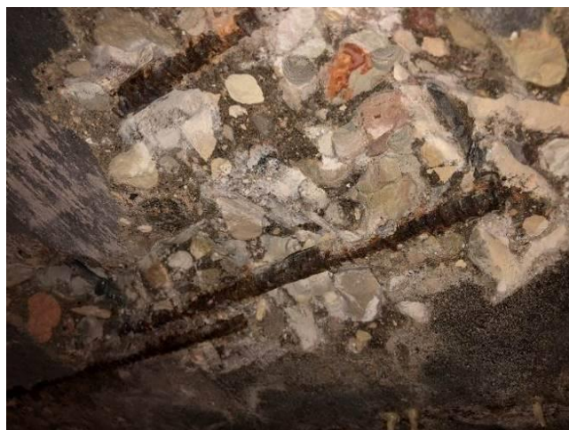
Foto Nr. 12 Daļējs stiegras profilējuma zudums.
