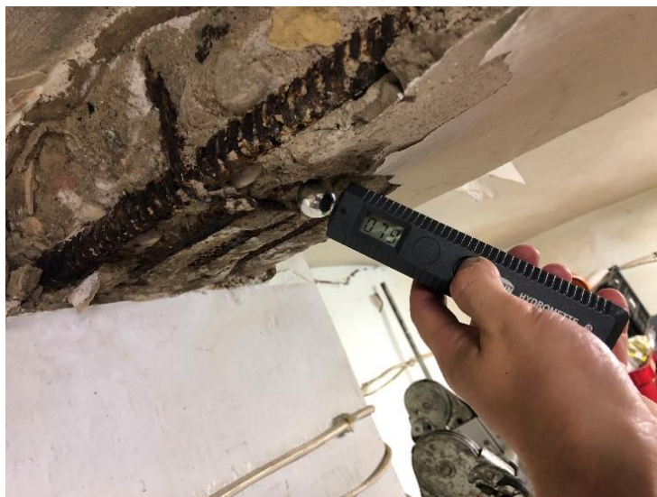
Foto Nr. 42 Mitrums betona konstrukcijā 4.0-5.0%CM..
