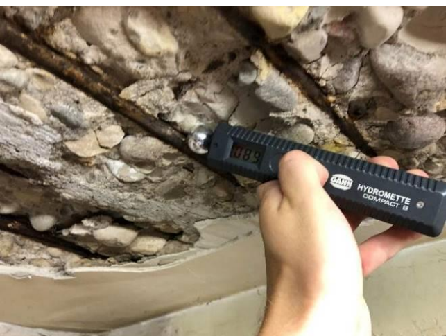
Foto Nr. 52 Mitrums betona konstrukcijā 4.0-5.0%CM.
