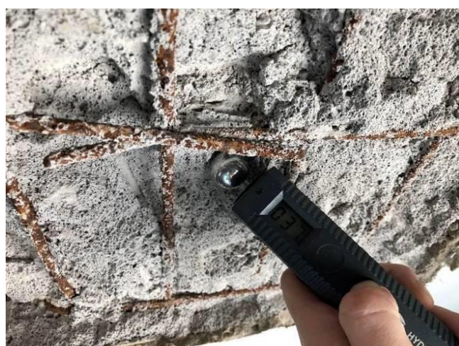
Foto Nr. 90 Mitrums gāzbetona konstrukcijā 0.8%CM.(rād. Vid.45).
