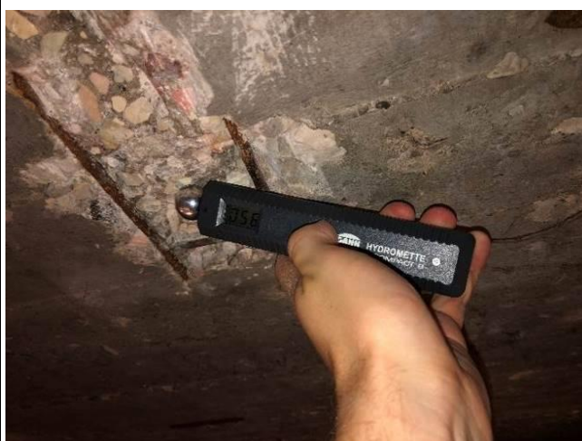
Foto Nr. 30 Mitrums betona konstrukcijā 2.5%CM.
