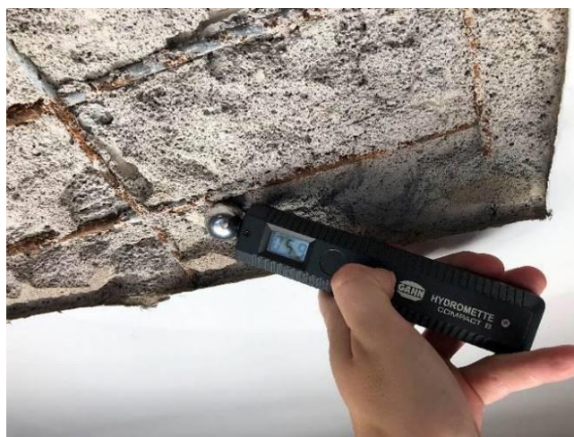
Foto Nr. 74 Mitrums gāzbetona konstrukcijā 0.5%CM.(rād. Vid.45)
