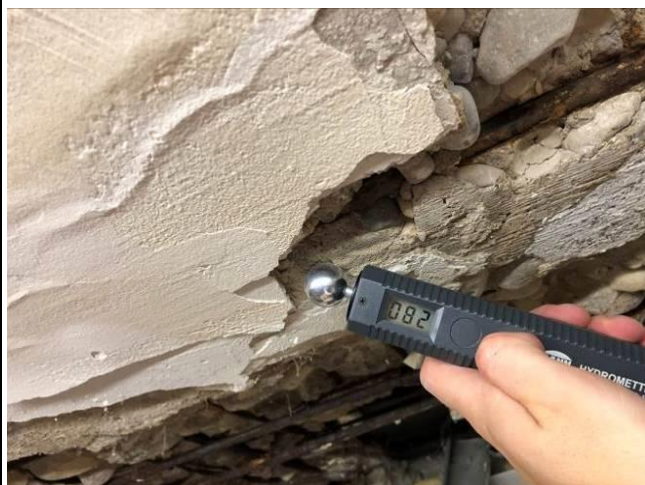
Foto Nr. 51 Mitrums betona konstrukcijā 4.0-5.0%CM.
