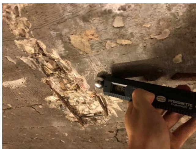
Foto Nr. 31 Mitrums betona konstrukcijā 2.5%CM.
