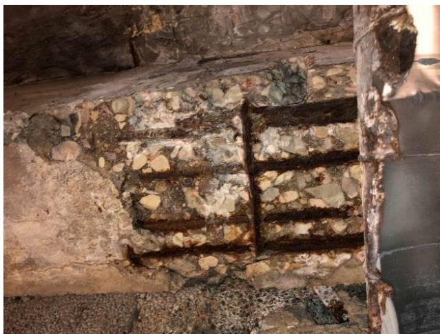
Foto Nr. 17 Stiegrojuma atsegums dz.betona sijā.
