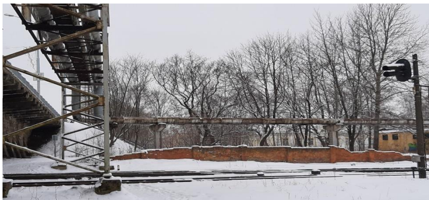
Att. Nr. 1. Esošā bojātā mūra siena (no Stacijas ielas puses)
