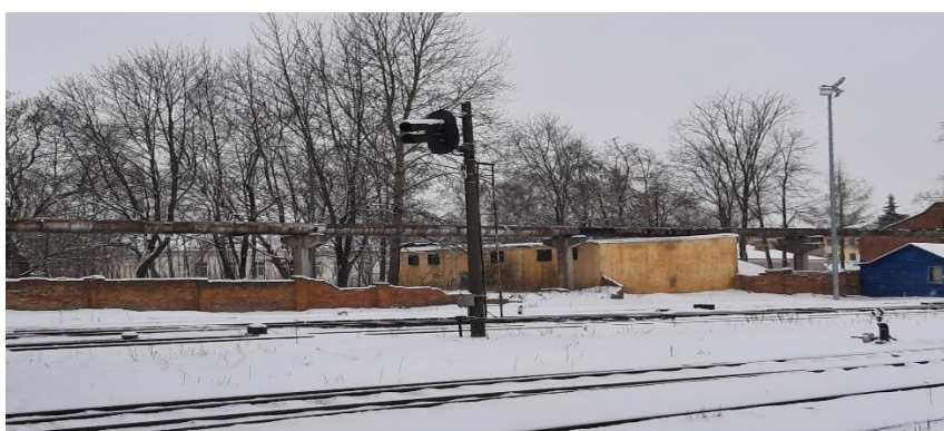
Att. Nr. 2. Esošā bojātā mūra siena (no Stacijas ielas puses)
