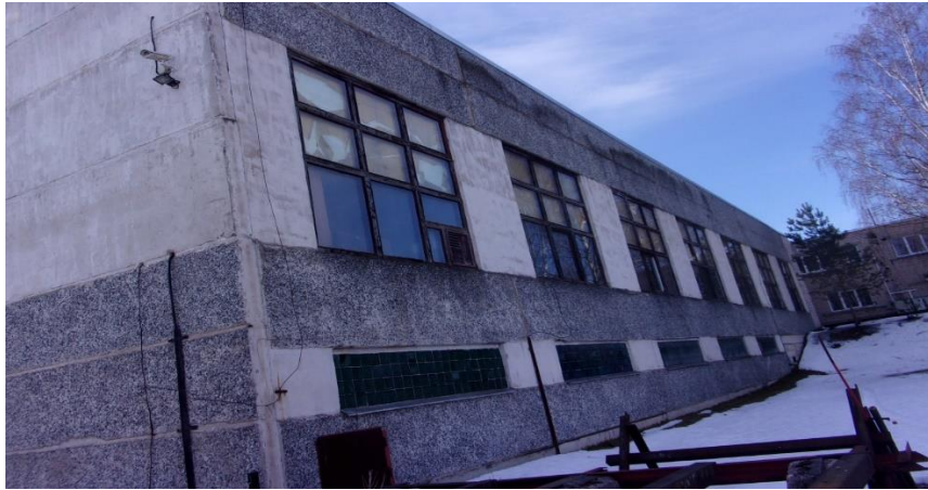
Att.Nr.7. Ēku Stacijas ielā 27, Rēzeknē fasāde (fotofiksācijas virziens saskaņā ar “Ēku vienkāršotas pārbūves shēmu”)
