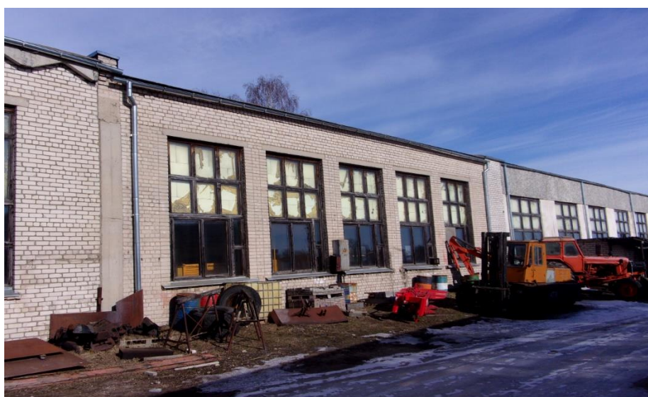
Att.Nr.2. Ēku Stacijas ielā 27, Rēzeknē fasāde (fotofiksācijas virziens saskaņā ar “Ēku vienkāršotas pārbūves shēmu”)
