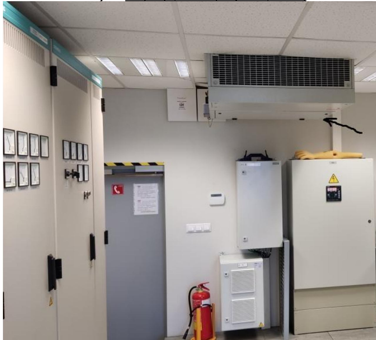
Objekts: Releju telpa, 102.kab. (st.Škirotava, uzkalns)
