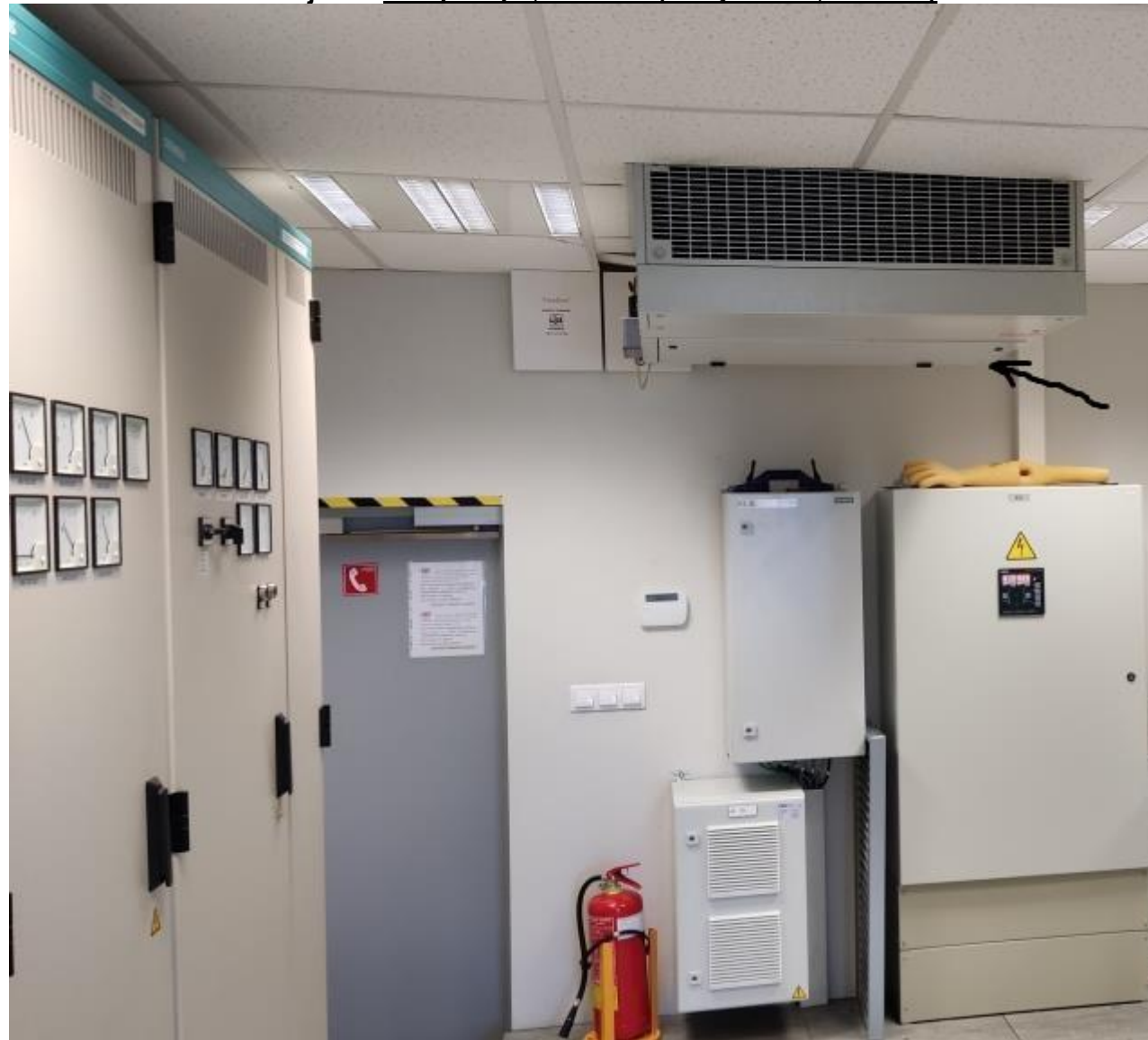
Objekts: Releju telpa, 102.kab. (st.Škirotava, uzkalns)
