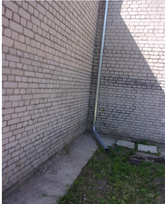
Attēls .Nr.1. Ēkas augstā daļa. Jumta lietusūdens novadīšanas caurule. Pie caurules nepieciešams ierīkot betona tekni
