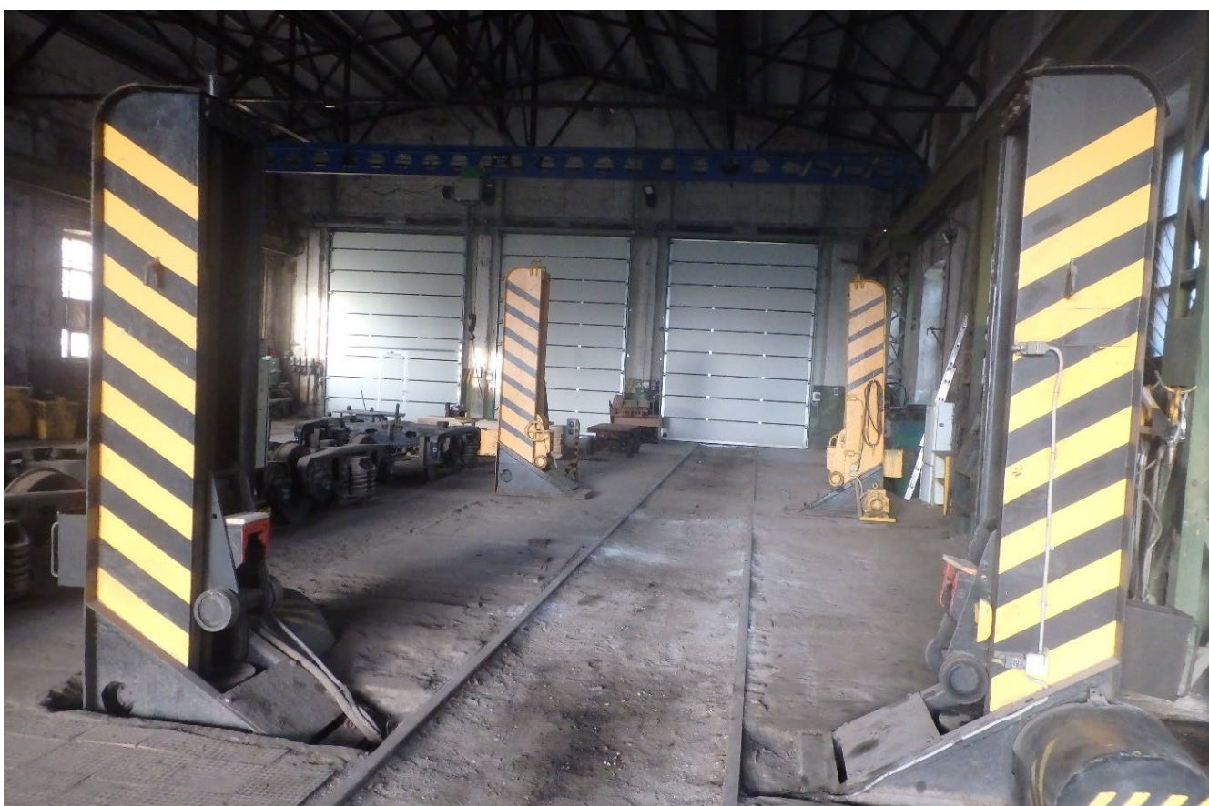
4. att. Elektrodomkratu komplekts TED-30 (4 gabali). Vagona pacelšanas divas pozīcijas uz pievedceļa Nr. 306. SAP Nr. 242000000640-0000, 242000000641-0000, 442000000480-0000, 442000000479-0000
